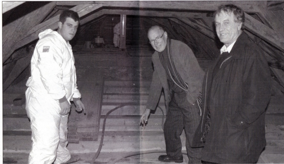
Die holzerstörenden Insekten werden nachhaltig bekämpft: Begehung im Dachstock der Alten Kirche mit (von links) Dimitri Hirt (Growe AG), Walter Hofmann und Charly Sigrist (beide Stiftung Alte Kirche). Fotos: sha
